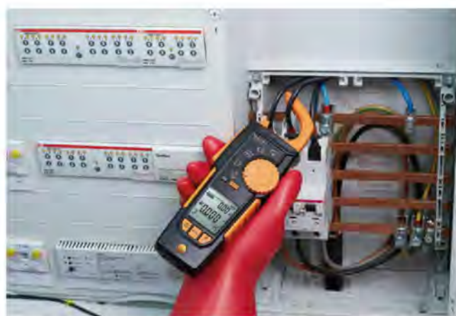
测量开关柜电流
