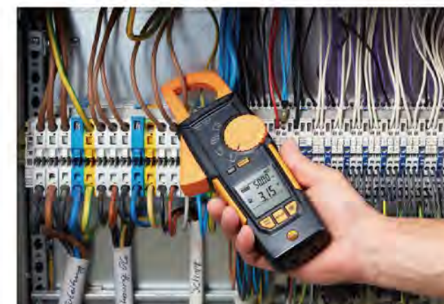
测量开关柜电流
