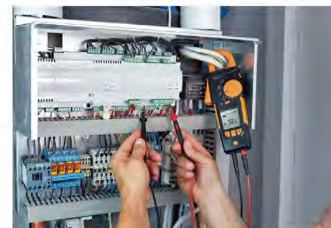
测量开关柜电压
