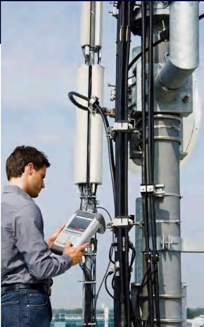
使用 R&S®ZVH 对移动无线电天线系统执行故障点距离测量
