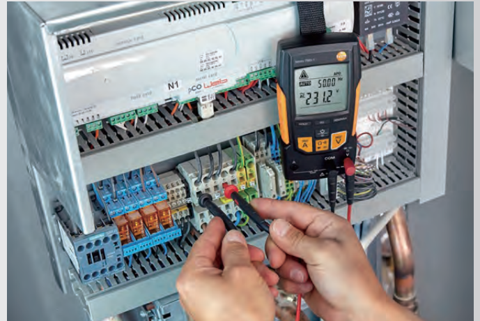
测量热泵开关盒中的电压
