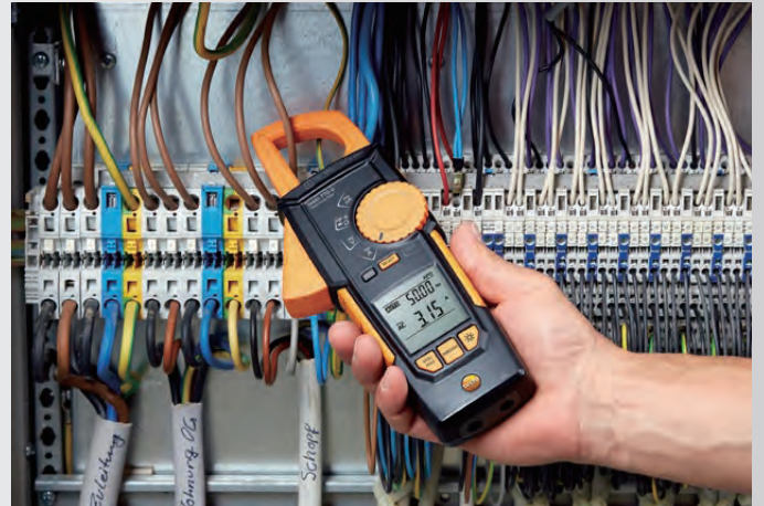
测量开关柜电流
