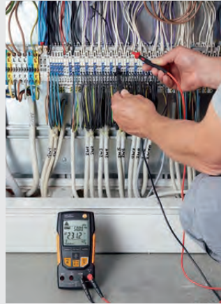
测量开关柜中的电压
