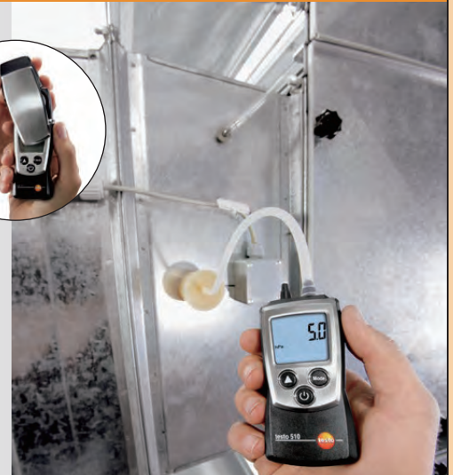
测量过滤器的差压
