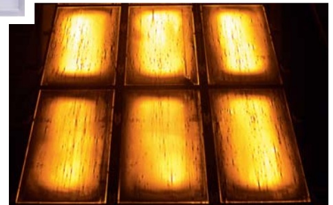
有破裂组件的CIS组串
