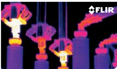
变电站的热图像，其中显示一个变压器温度过高。
