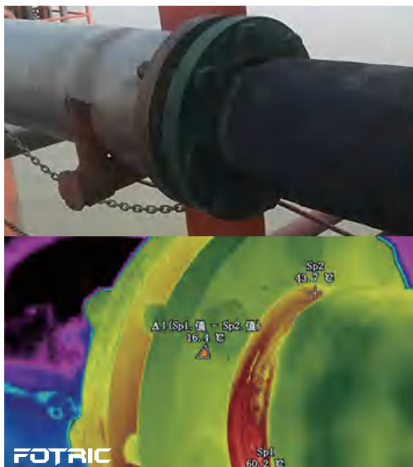
管道法兰连接处老化
