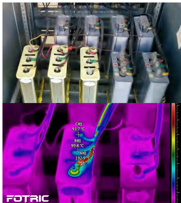
配电柜电容接头温度检测
