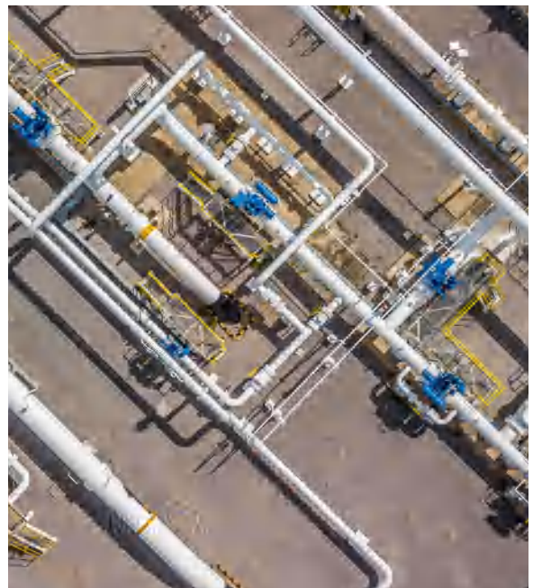
油气输送管道
