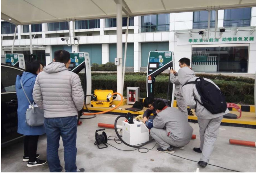
交流桩现场计量测试（浙江华电器材）
