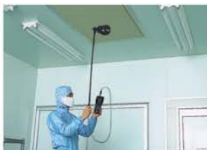
高效过滤器出风口测试
