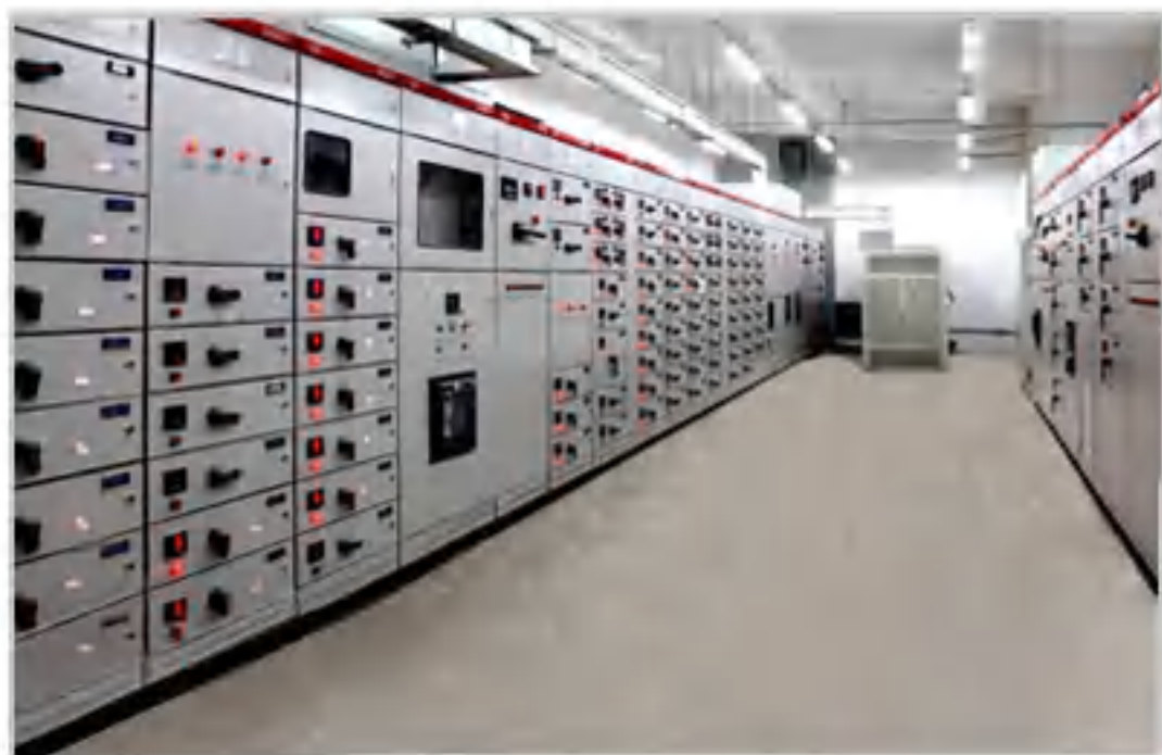
中低压配电柜
