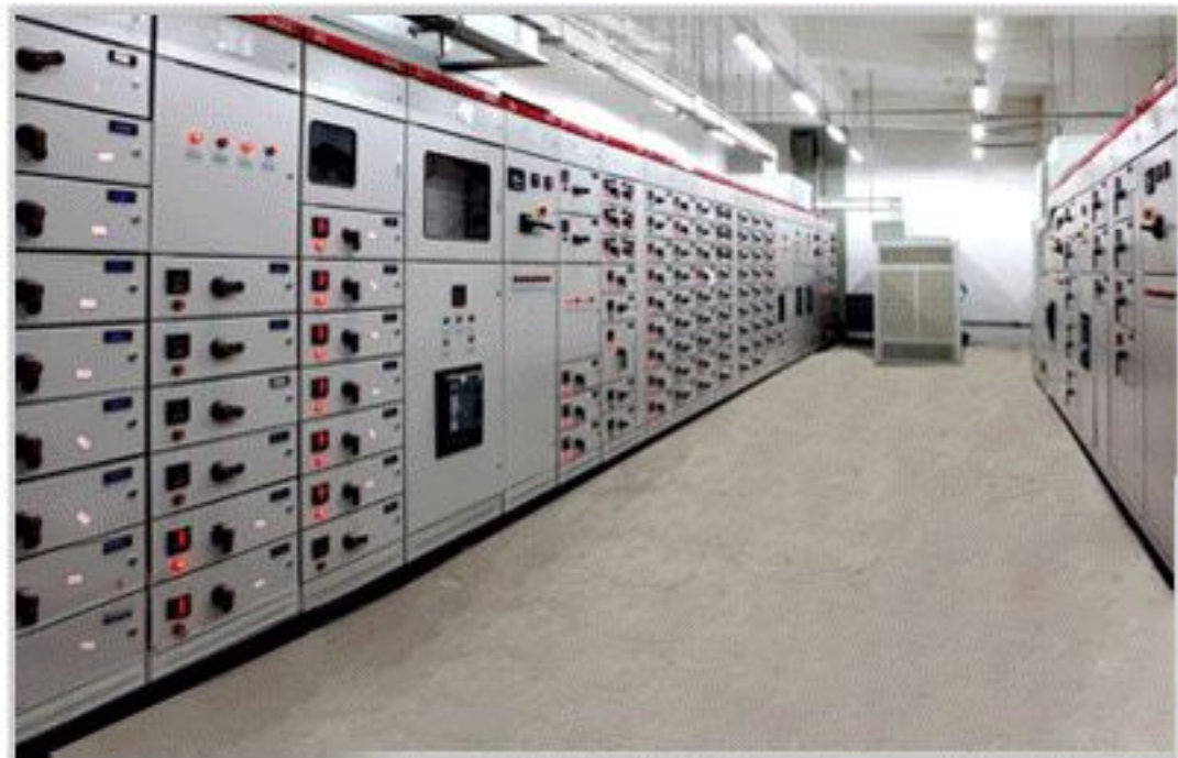
中低压配电柜
