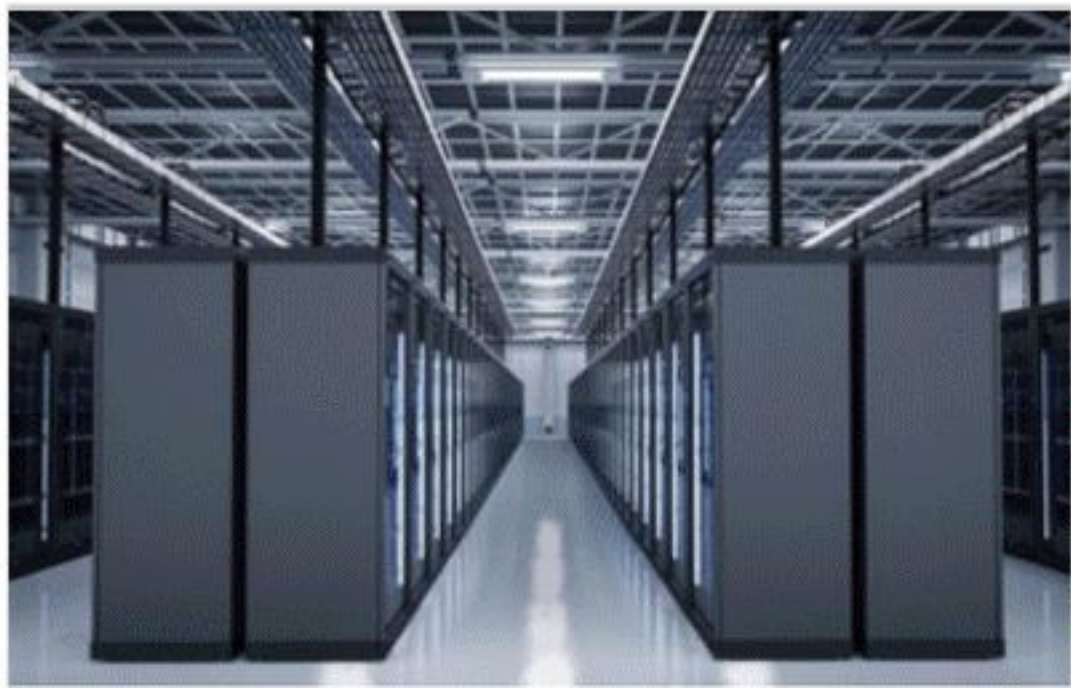
通讯数据中心
