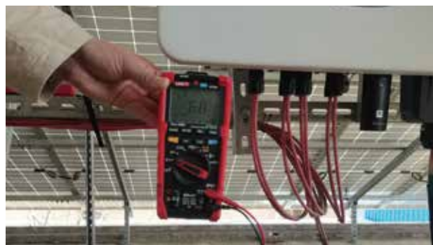
光伏电压测量
