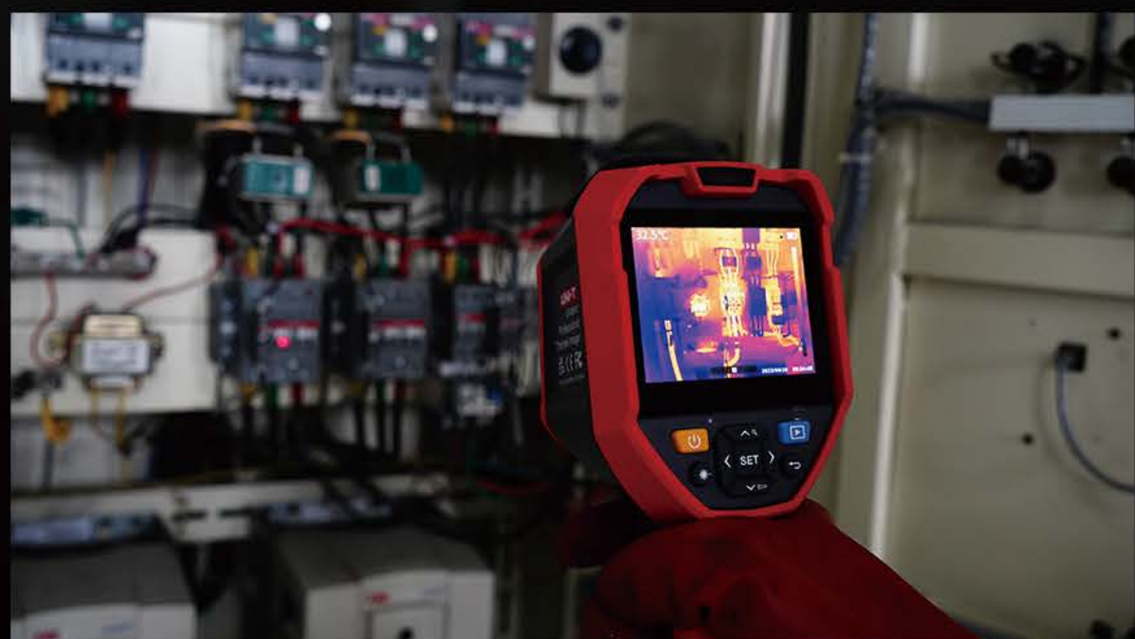
配电柜温度筛查检测
