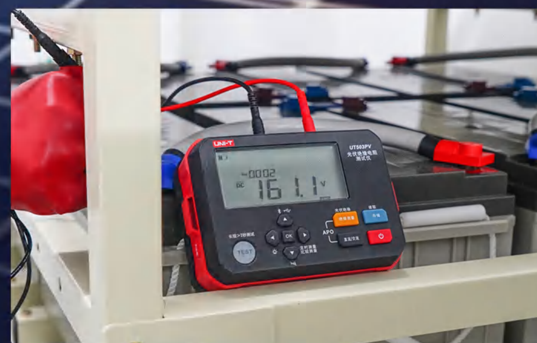
蓄电池直流电压测量
