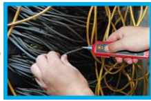
在交换机上找线
