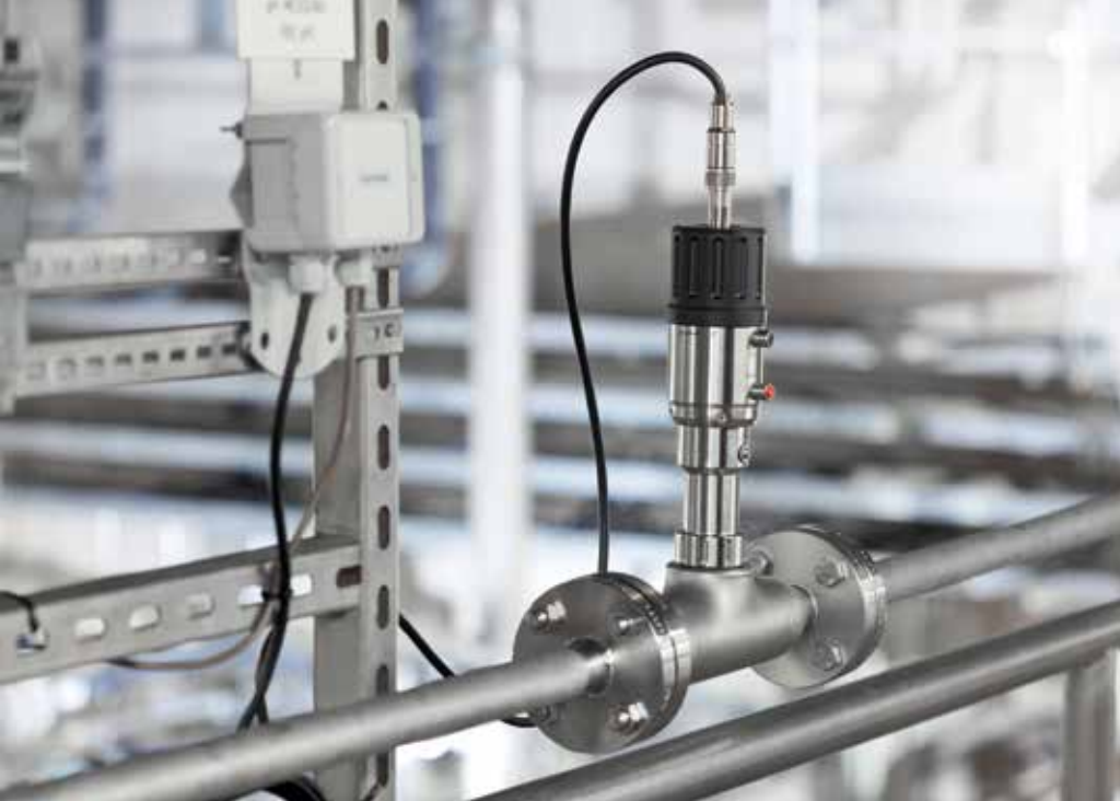
配备 SENSOFIT RET 5810 支架的 SMARTPAT PH 8150, 安装于化工厂
